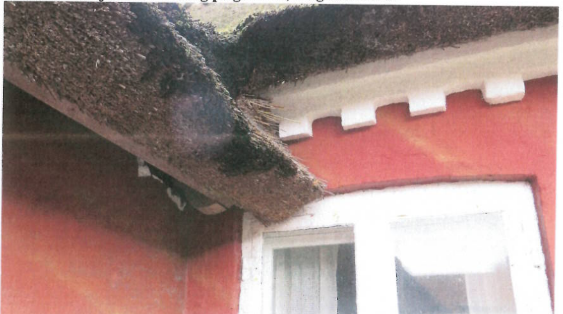
Godt tækkehåndværk, men vinduet kan ikke længere åbnes ! Apr. 2015.
