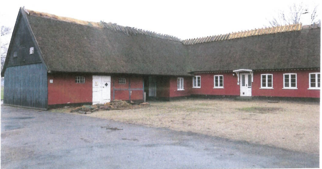
Seruminstituttet vedligeholder beundringsværdigt i hvert fald tagene: Her udbedres stormskader på rygningerne efter 'Bodil'-stormen i december 2013. ( Jan.2014)
